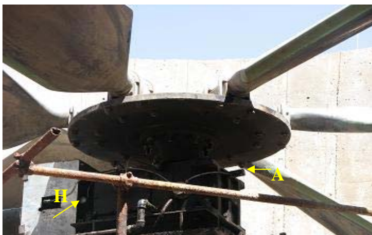
شکل ۱۸- تصویر گیربکس و موقعیت سنسورهای ارتعاش برداری سیستم Online.
