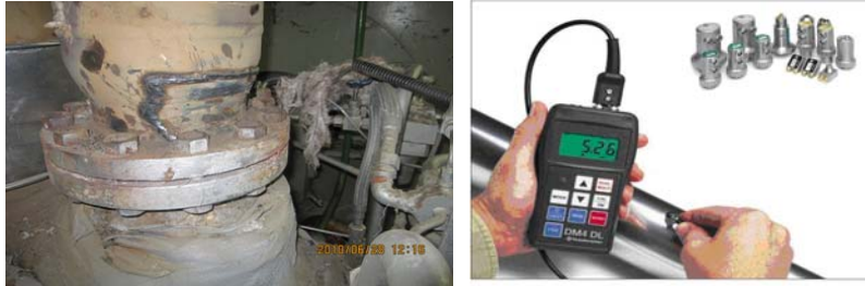
شکل ۹- دستگاه ضخامت‌سنج شرکت کرات کرامر شکل ۱۰- فشارشکن خروجی بوسترپمپ آب تغذیه (ترمیم محل خوردگی)
