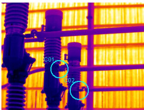
شکل ۱۰- تصویر حرارتی بعد از رفع عیب
